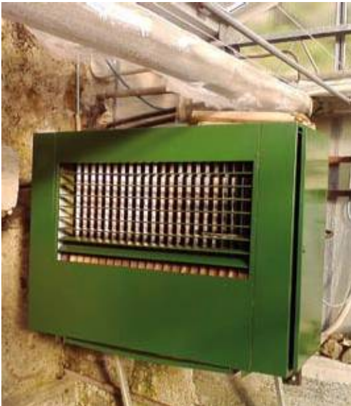
Aerothermo per la climatizzazione: generatore di aria calda alimentato da acqua calda (Azienda Gaggero, Mele - GE).
