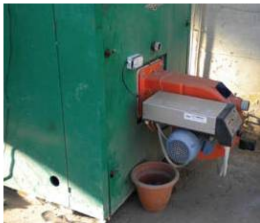
Caldaia tradizionale con bruciatore a gasolio.
