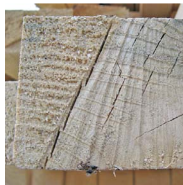
Fessura da ritiro su testata di segato Fente en bout sur sciage
