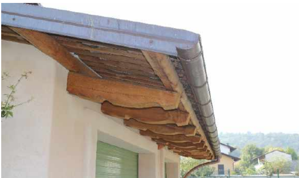
Figura 2. Esempio di travatura sotto copertura (foto Segheria Valle Sacra).
