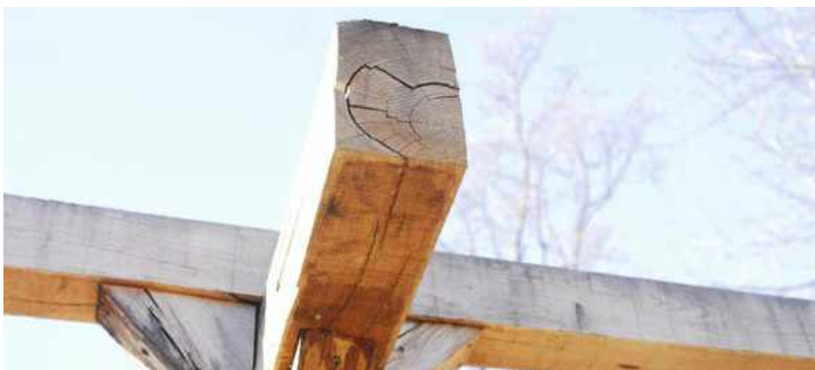
Figura 2. Cipollatura multipla su trave in opera.
